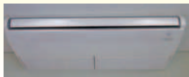
東江上区(エアコン2台)
