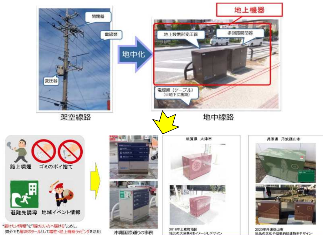
図-24 ラッピングによる地上機器活用(参考: 沖縄電力(株)配電部)
