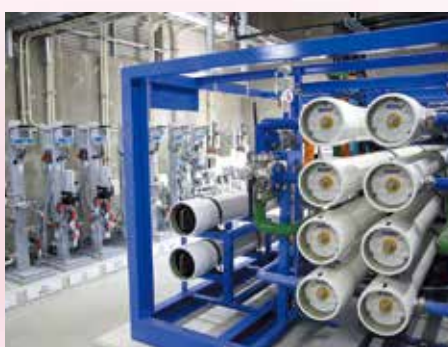
城山浄水場の内部
