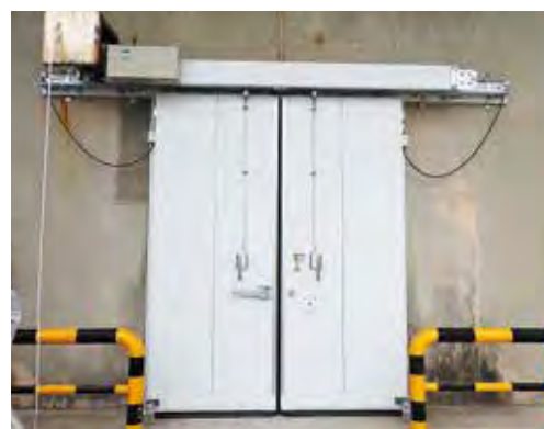
水産業冷蔵設備
